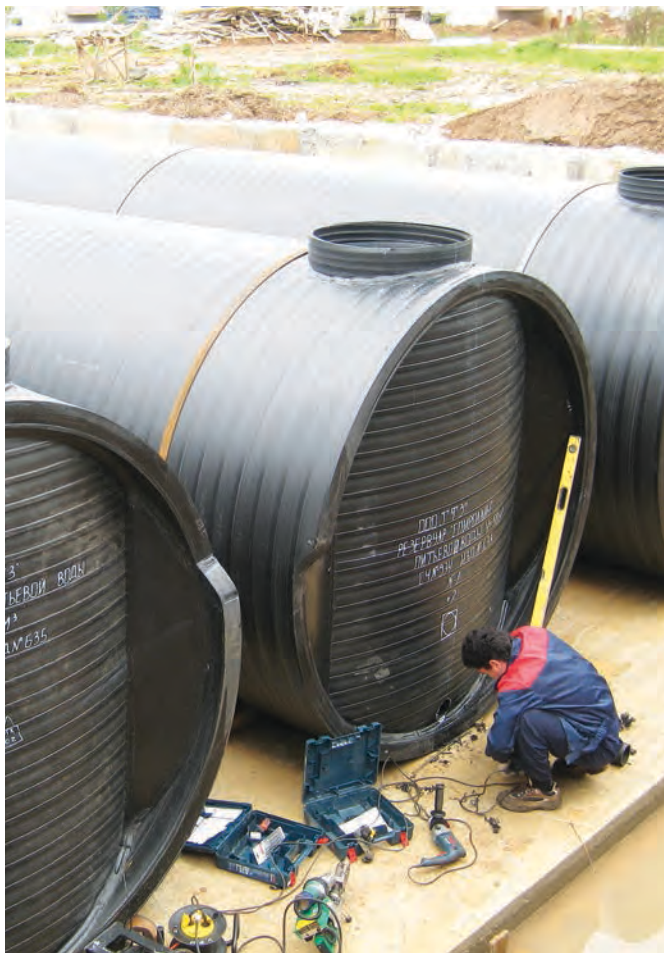
Рис. 3. Резервуар для технической воды из полиэтилена
